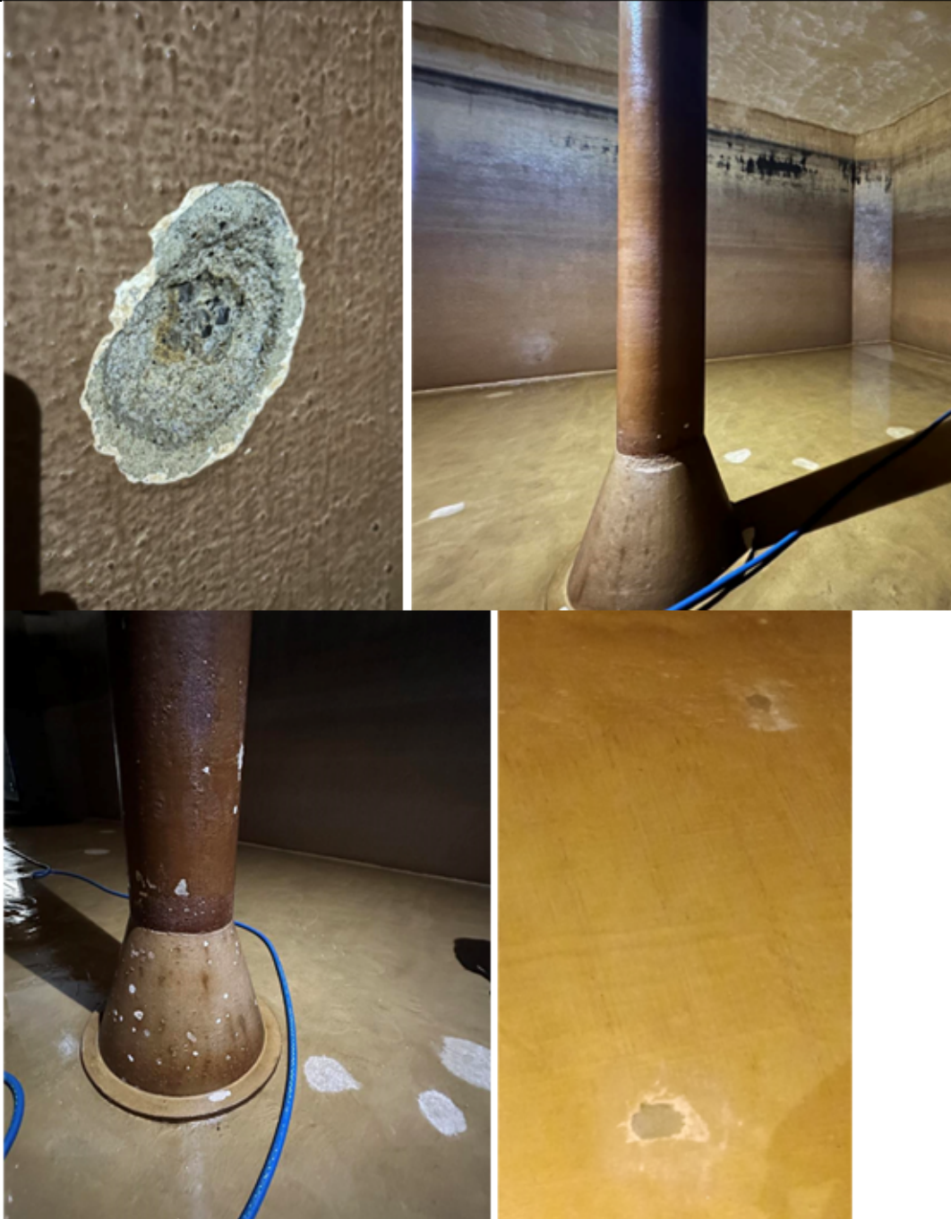
Abplatzungen an Behälterauskleidung
