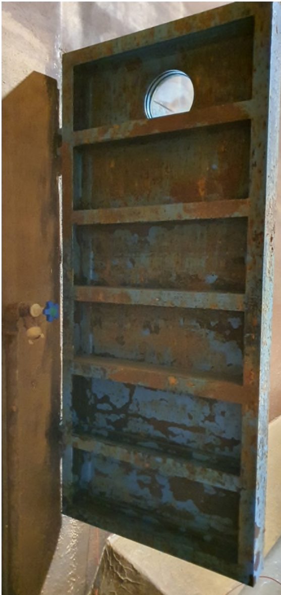
Abb. 5: Markierung 4: Korrodierte Drucktüre
