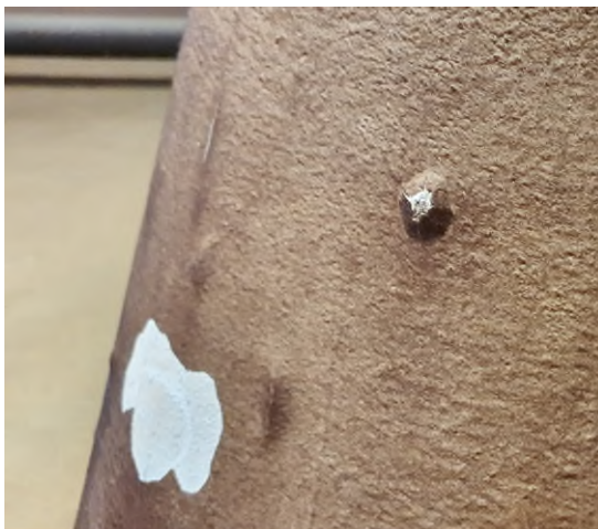
Abb. 3: Markierung 2: Abplatzung (hart) der Beschichtung und Blasenbildung, nur an den Säulen
