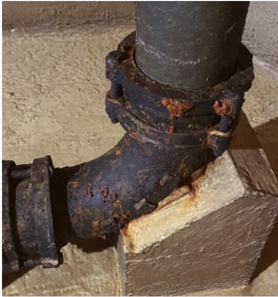
Abb. 4: Markierung 3: Stark Korrodierte Leitungsteile in der Wasserkammer
